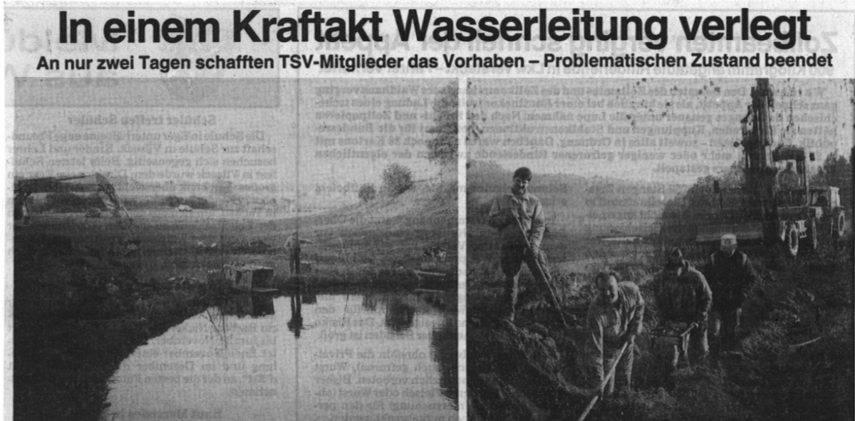
Alfons Buchner (linkes Bild) war der Retter für den TSV, der keine Kosten und Mühen scheut, um seine Wasserversorgung aus diesem Weiher in der Ziegelwiese zu sichern. An nur zwei Samstagen haben Mitglieder der Fußball- und Tennisabteilung eine große Gemeinschaftsleistung vollbracht. Bilder: es
